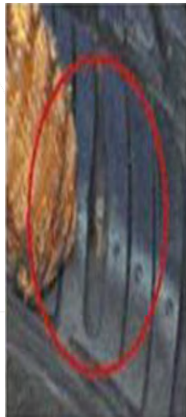
5. ความเสียหายเป็นรู (penetration damage)
